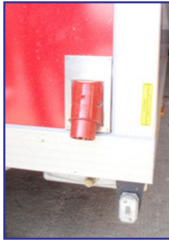
Außenanschluss für Strom
