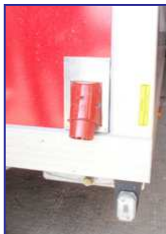
Außenanschluss für Strom
